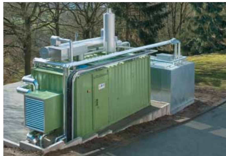
Rittal in Herborn: 340 kW Pflanzenöl – BHKW mit 36 m³ Kraftstofftank von Würz Energy
