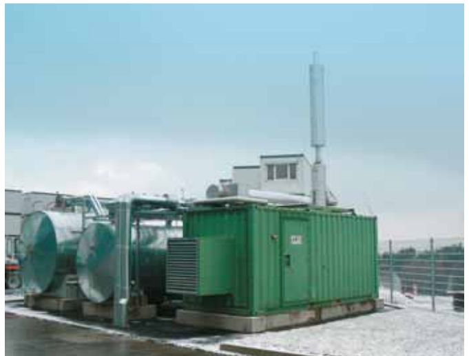
150 kW el. U kontejneru sa rezervoarom za gorivo zapremine 35 m 3 i sa spremnikom za toplu vodu – STV zapremine 26 m 3
