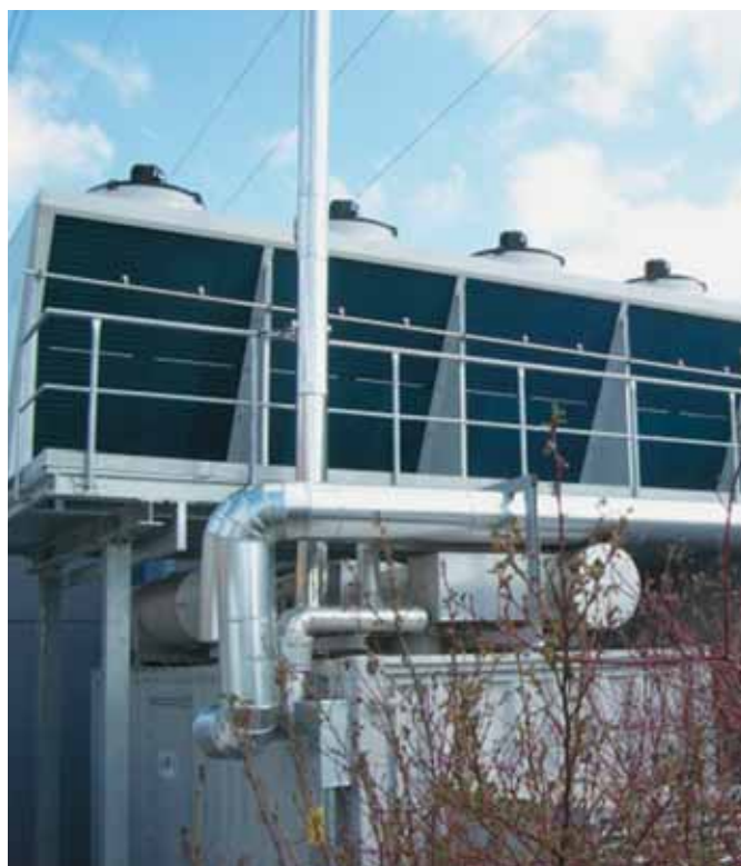
40 кВт эл., в контейнере 220 кВт абсорбционная холодильная машина 50 м 3 резервуар для топлива, 60 м 3 резерв. для ГВС/хол. воды для кондиционир.
