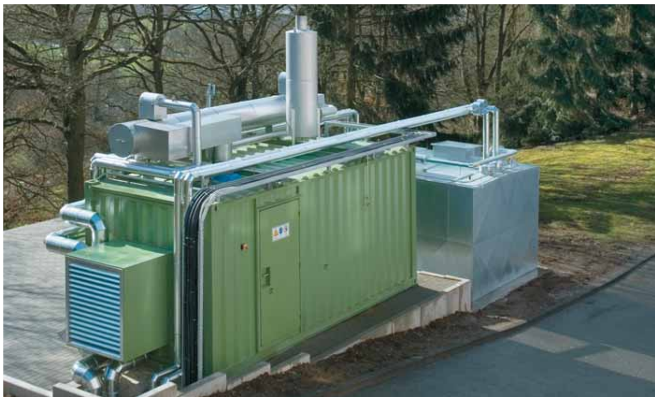
Компания RITTAL в Херборне, Германия. Установка с резервуаром для топлива емкостью 30 м 3 – WE-CG-340-V
