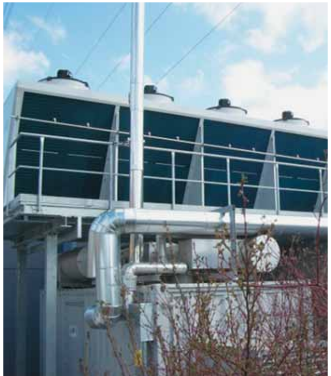
340 kW el. u kontejneru 220 kW absorpcijski uređaj za hlađenje 50 m 3 tank za gorivo 60 m 3 spremnik za STV/hladnu vodu za klimatizaciju
