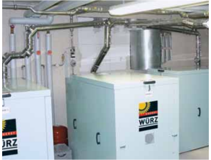
4 x 30 kW Erdgas-BHKW mit Schalldämmhaube und 2 x 5 m³ Pufferspeicher
