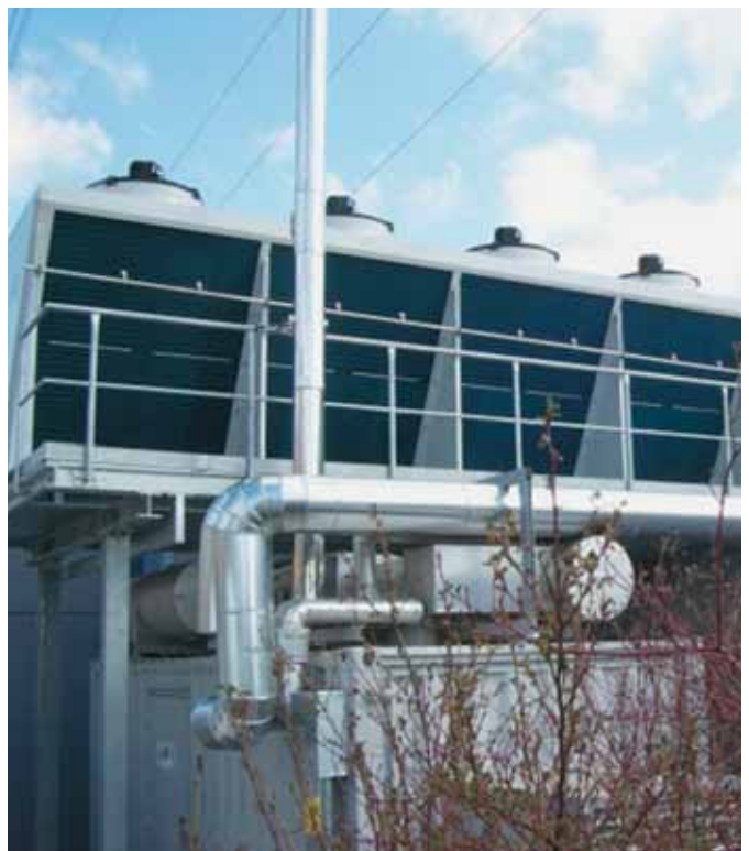
340 kW BHKW im Container mit 220 kW Absorptionskälteanlage, 50 m 3 Pflanzenöltank und je 60 m 3 Pufferspeicher für Wärme und Kälte
