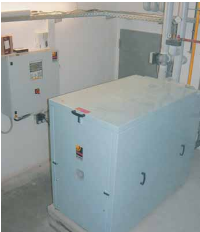
30 kW Erdgas-BHKW mit Schalldämmhaube und 2 m 3 Pufferspeicher
