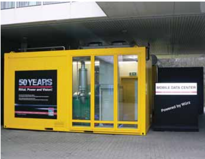
2 x 8 kW Pflanzenöl-BHKW mit 10 kW Absorptionskälteanlage, 750 Liter Kraftstofftank und 1.100 Liter Wärmespeicher im Container
