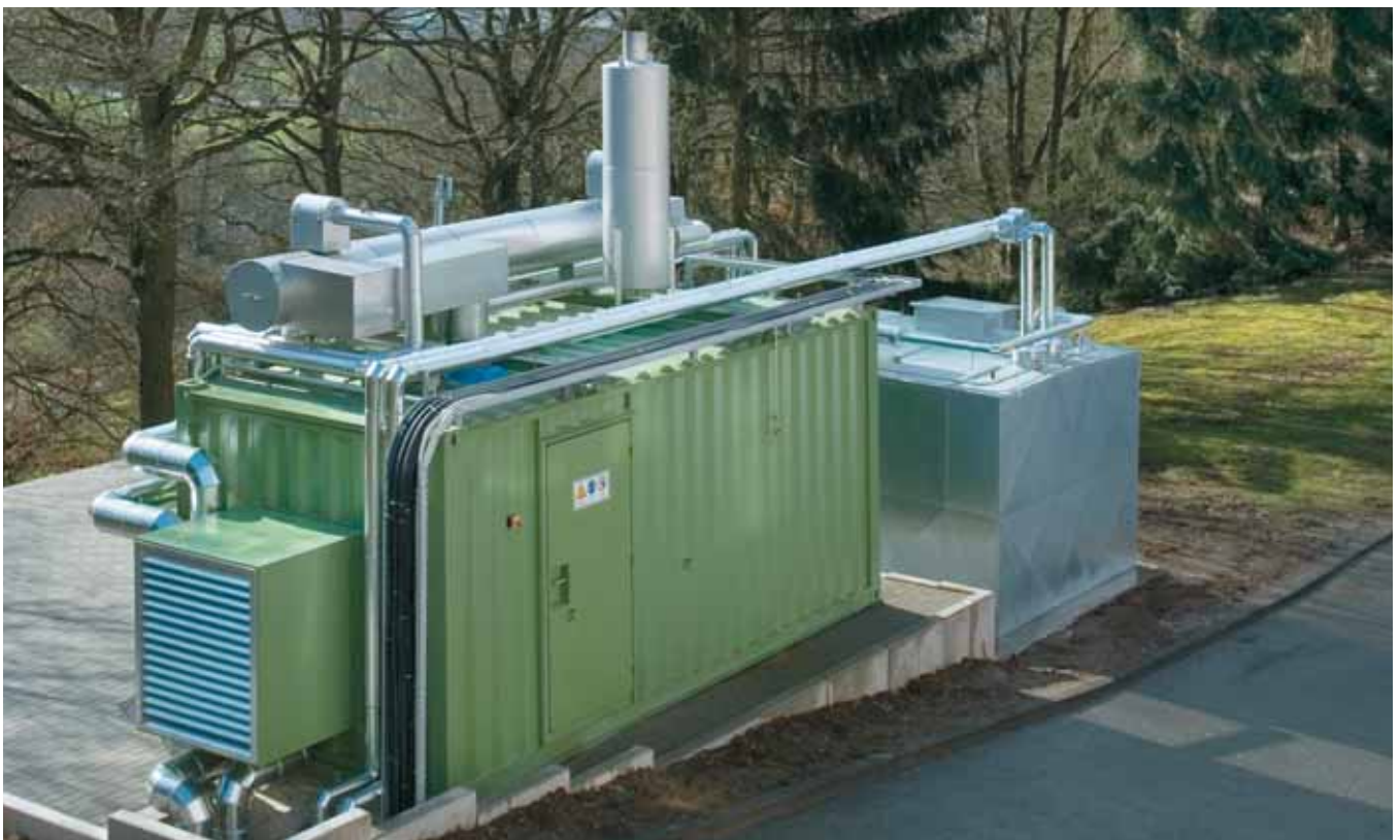
Rittal in Herborn, Deutschland: 340 kW Pflanzenöl-BHKW mit 36 m 3 Kraftstofftank von Würz
