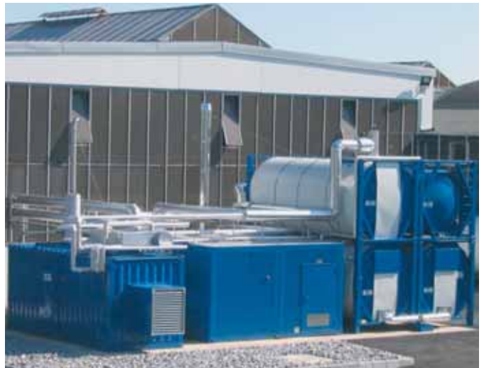
120 kW Pflanzenöl-BHKW im Container mit 2 x 24 m 3 Pflanzenöltank, Heizölheizung mit 24 m 3 Heizöltank und 24 m 3 Pufferspeicher
