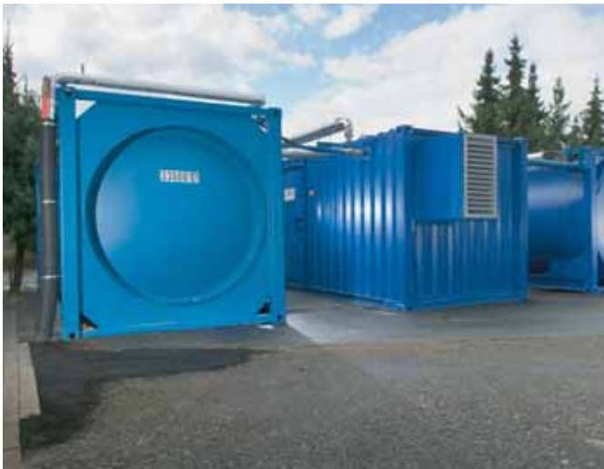
90 kW Pflanzenöl-BHKW im Container mit 25 m 3 Tank und Pufferspeicher
